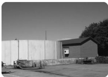
Рис. 20.1. Резервуар предварительного накопления
