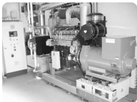
Рис. 20.7. Модуль КГУ мощностью 200–300 кВт
